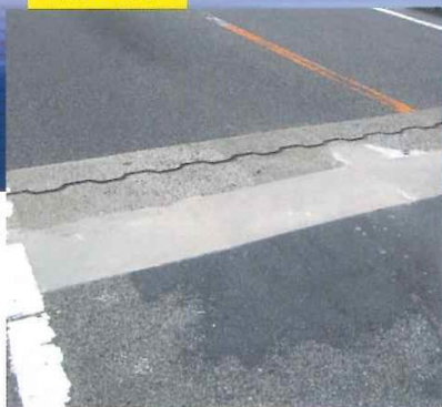
段差・隙間部分
